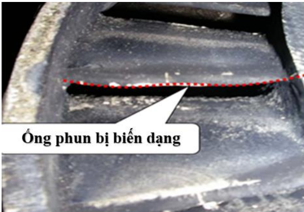
Hình 4. Ống phun bị mài mòn và cong vênh.
